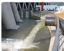
发电厂循环水
